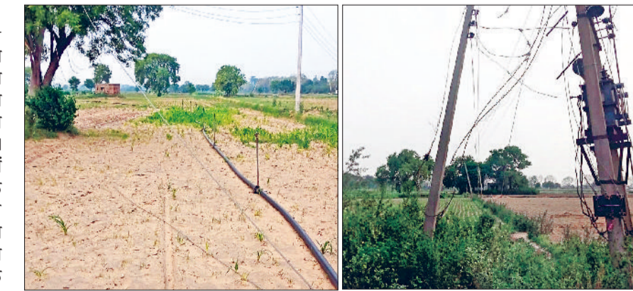
झज्जर। खेत में लगा हुआ ट्रांसफार्मर जहां से टूटी है तारें तथा खेत में टूटी पड़ी बिजली की तार। फोटो: हरिभूमि
